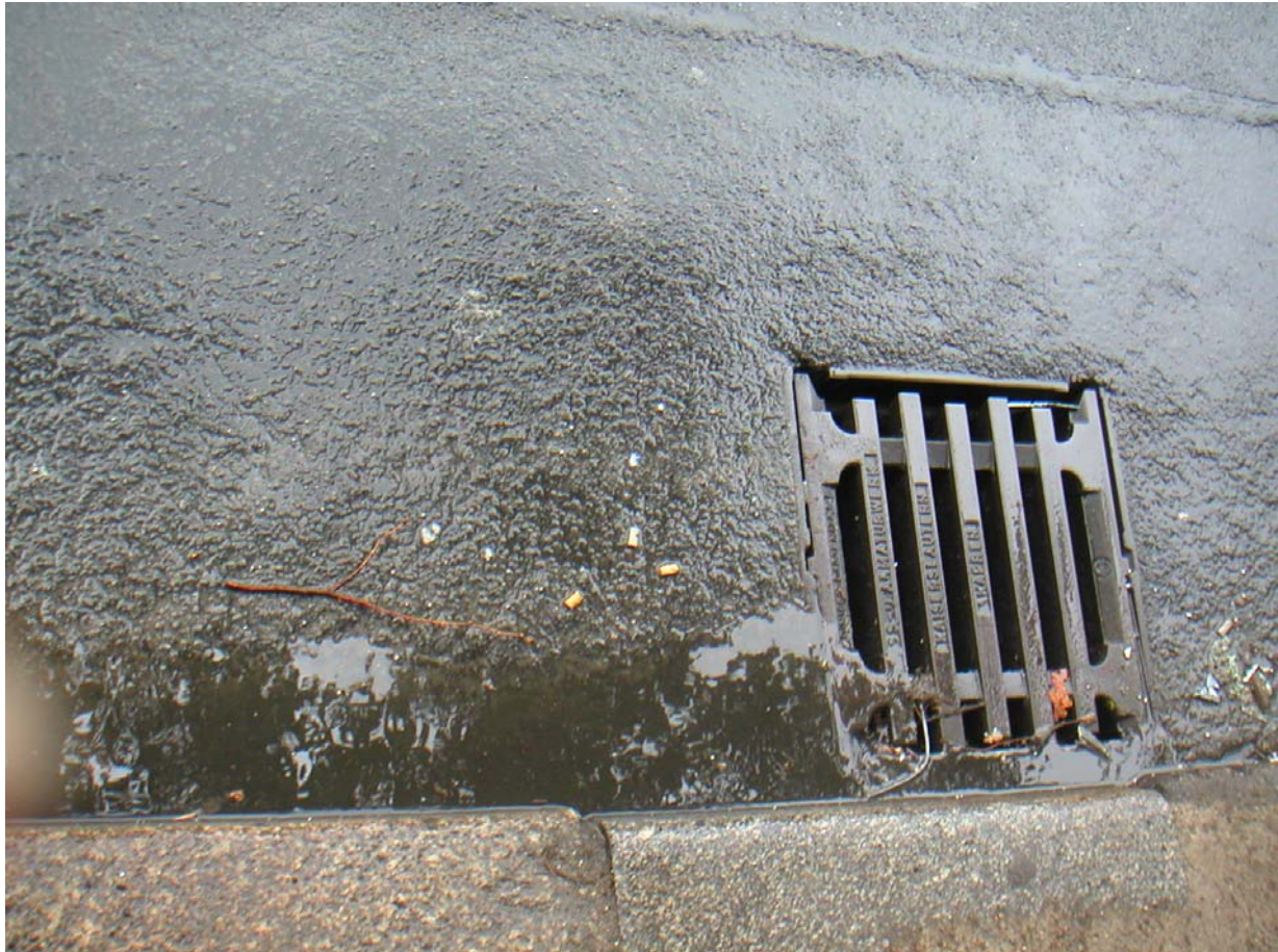
Abb. 2.4: Gully auf der Frankfurter Allee kurz nach einer Spülung am 12.05.2004
